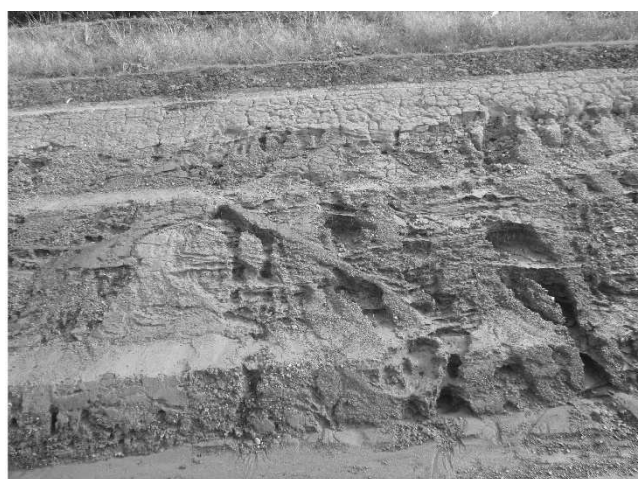
湧水箇所② 腐植混じり土
